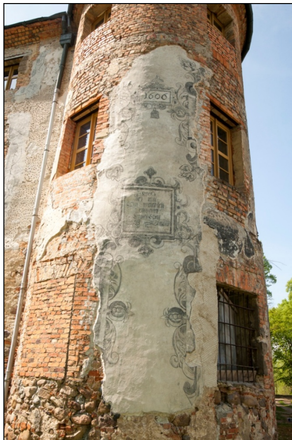
Broniszów Ubytki w elewacji zamku odsłaniają renesansową dekorację sgraffitową o motywach roślinnych.
